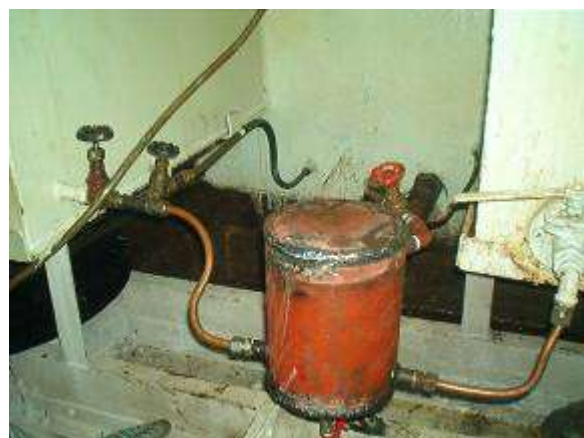
De nieuw waterzak met aftapkraan tussen de twee gasolietanks.
